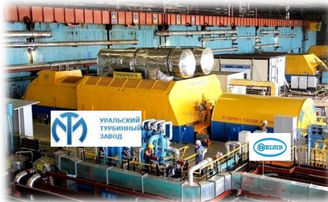
Турбоагрегат на ТЭЦ-4, г. Улан-Батор
